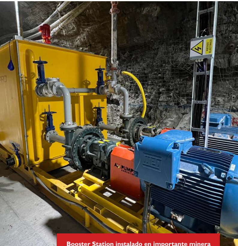
Booster Station instalado en importante minera radicada en la Provincia de Santa Cruz
